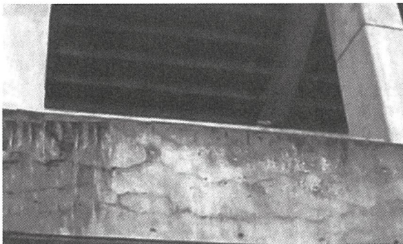
写真3 梁のひび割れ状況
