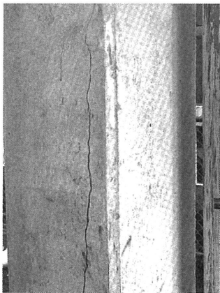
写真3 1階ピロティ部にある外部柱表面の変状
