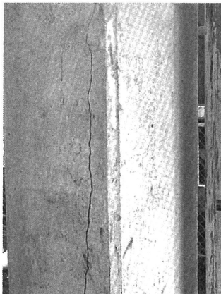
写真3 1階ビロティ部にある外部柱表面の変状
