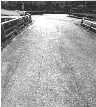
写真1 路面のひび割れ
