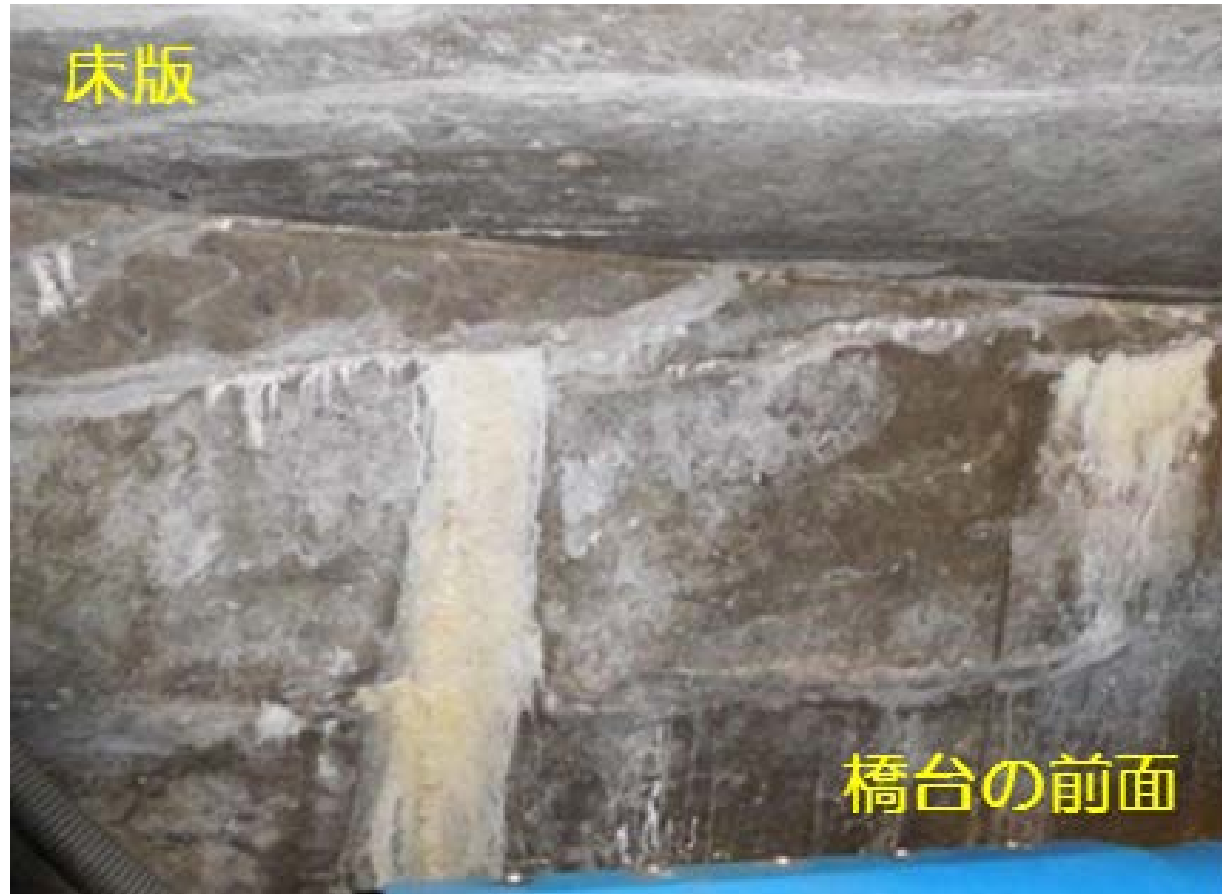
写真-5 橋台上面の伸縮装置からの漏水による遊離石灰の析出
