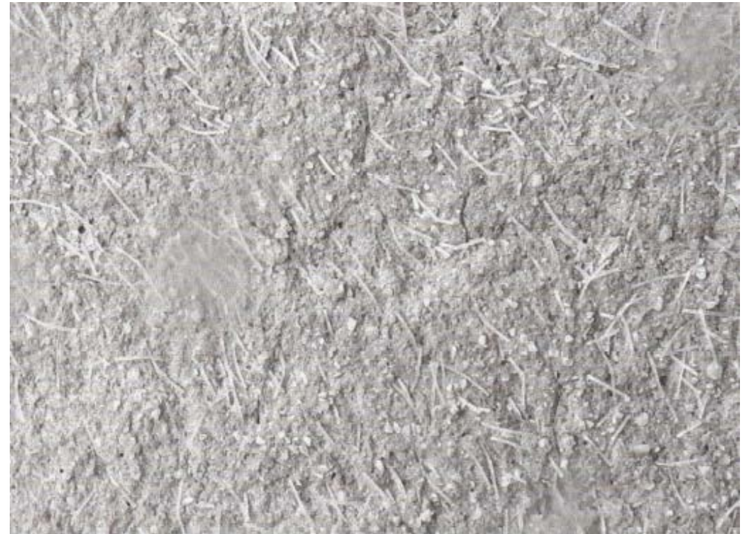
写真-11 摩耗により繊維露出
