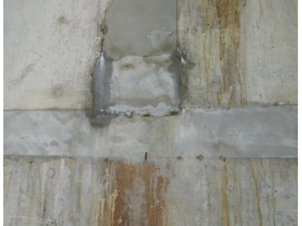
写真-7 橋台前面のVカット補修部の漏水と遊離 石灰の析出
