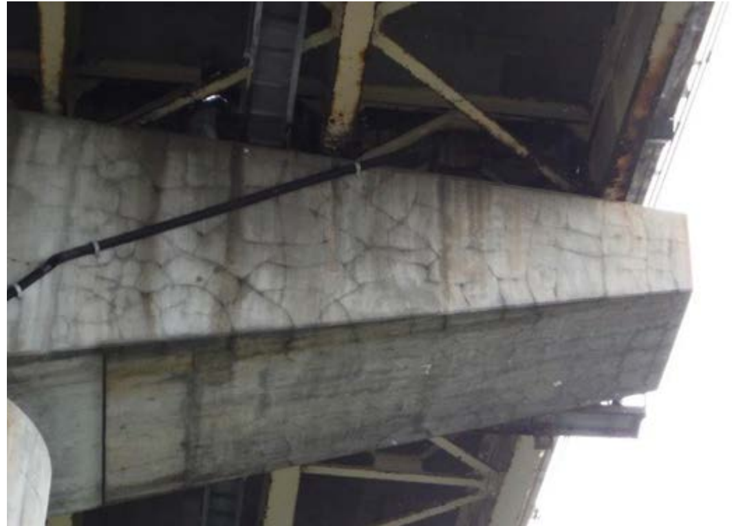
写真-2 上面の伸縮装置からの水掛りによるひび割れ
