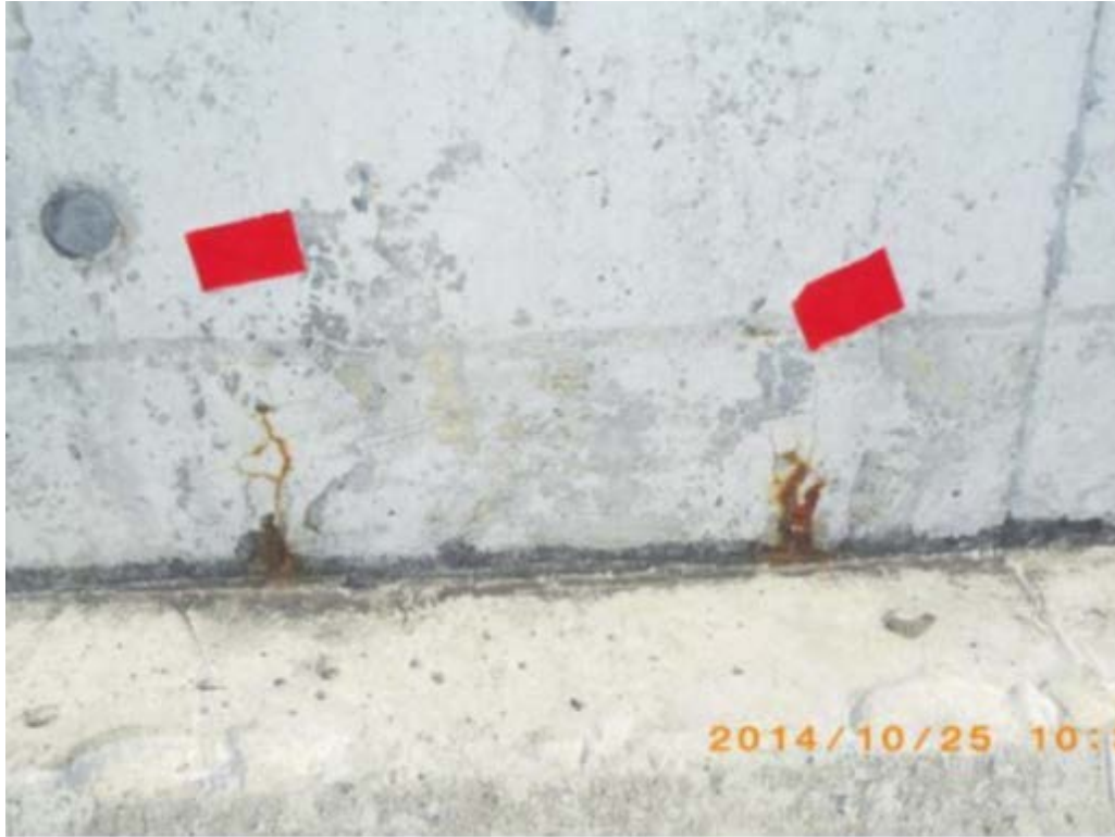
写真-8 鉄筋のかぶり不足による錆
