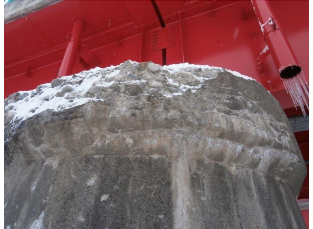
写真-4 水掛りによる断面欠損
