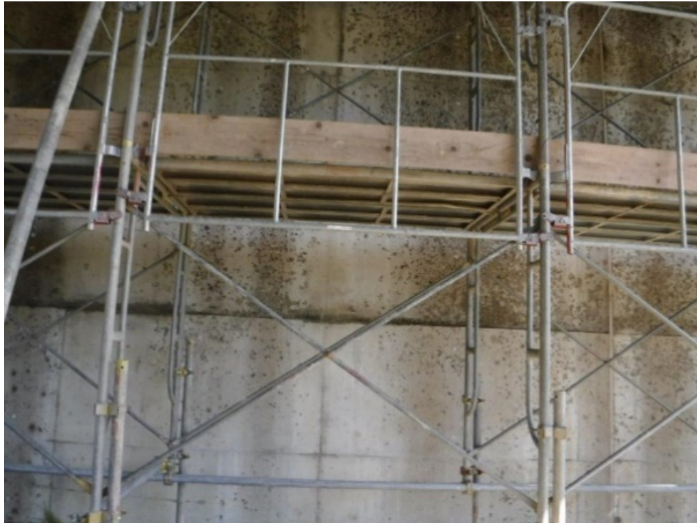
写真-1 スケーリング
