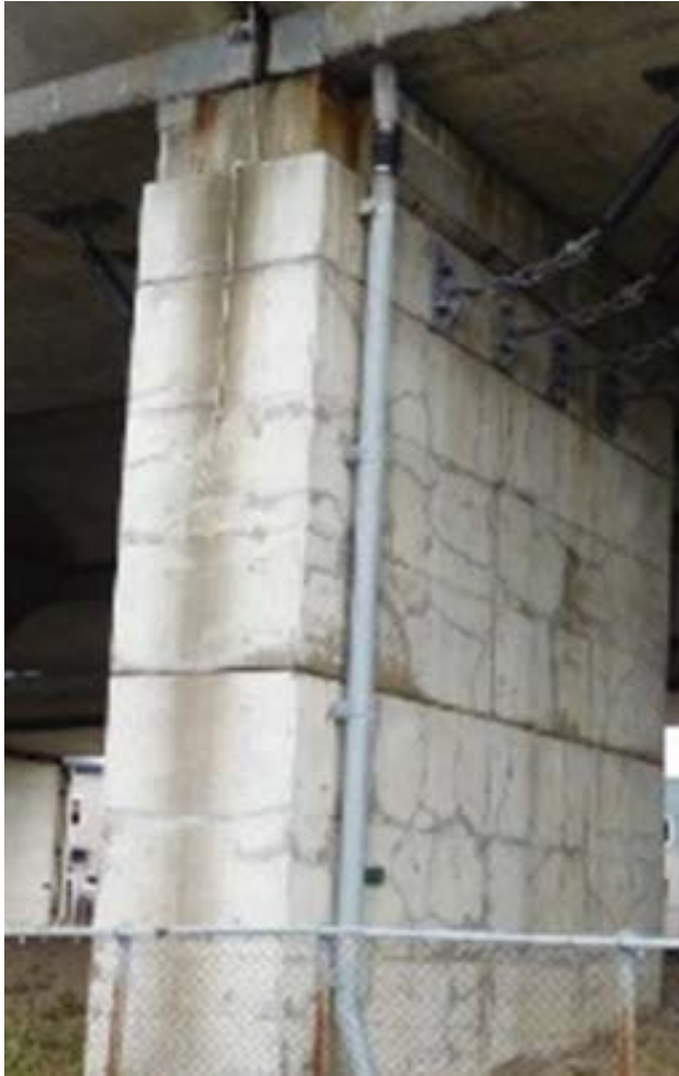
写真-6 伸縮装置から漏水により補強巻立 コンクリート界面への水の浸透
