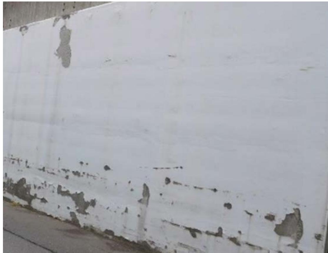
写真-10 被覆材の剥離・剥落
