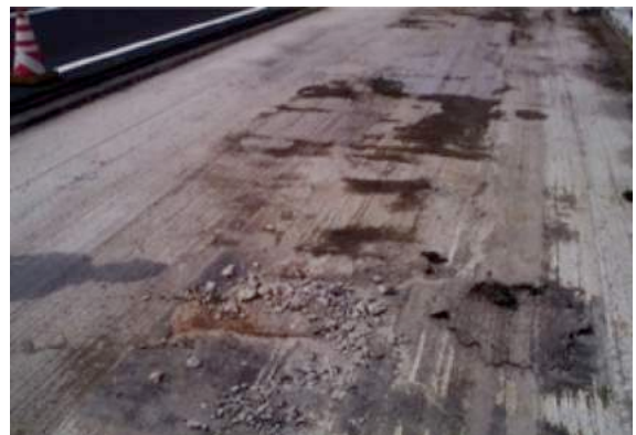
写真-2 コンクリート床版の劣化状況
