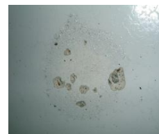
写真-2 直火を受けたコンクリート
