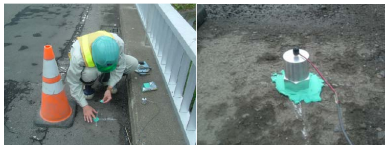
写真 3-2 センサー設置状況
