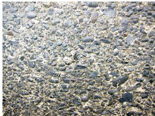
写真-1 骨材が露出したコンクリート表面
